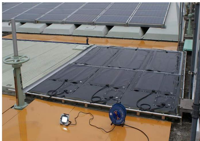
【実証実験場所】 東京都下水道局 森ヶ崎水再生センター
